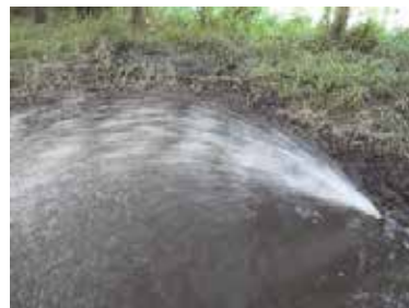
使用したポンプの様子
