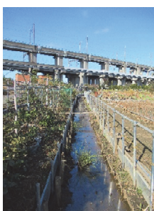
（側溝の安全柵）
